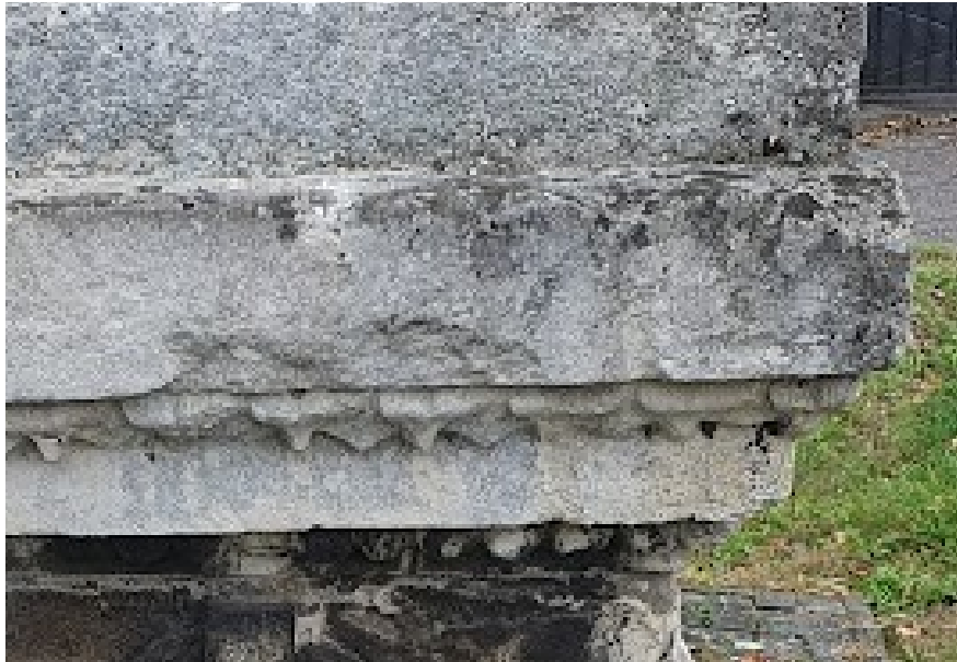
Fot. 18. Uszkodzenia mechaniczne – uszkodzony narożnik
