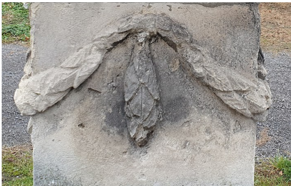
Fot. 17. Uszkodzenia mechaniczne w postaci dziur.
