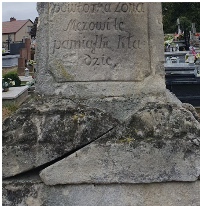
Fot. 13 -14. Widoczne pęknięcia kamienia.
